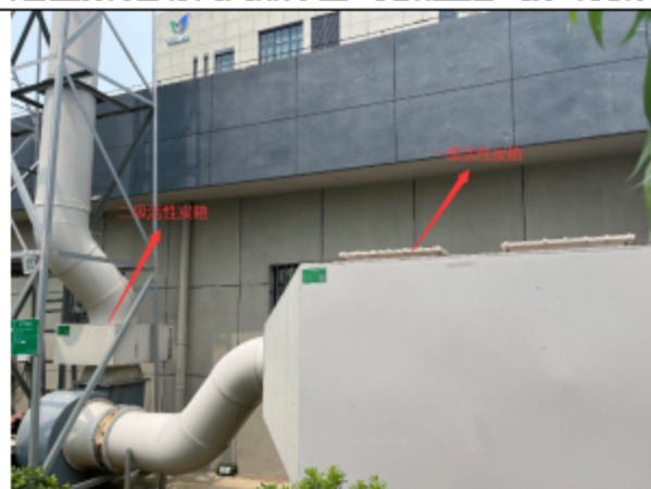
废气处理设施
