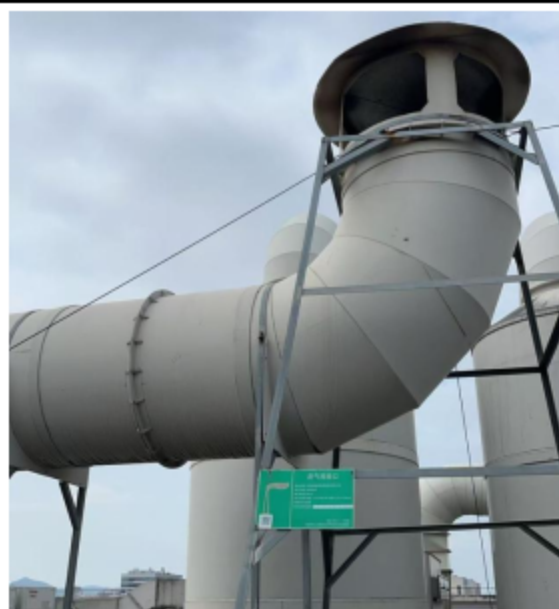
FQ-02 废气排口及采样口
