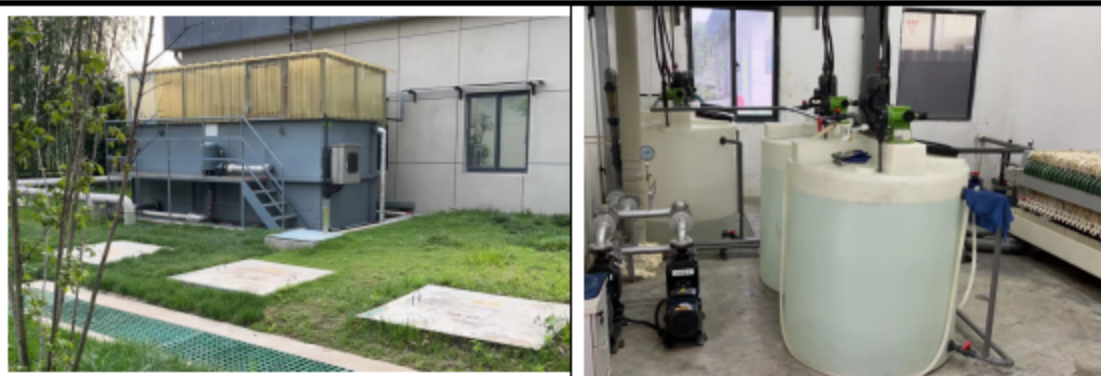
江苏威凯尔污水处理站
