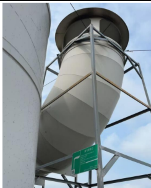
FQ-01 废气排口及采样口
